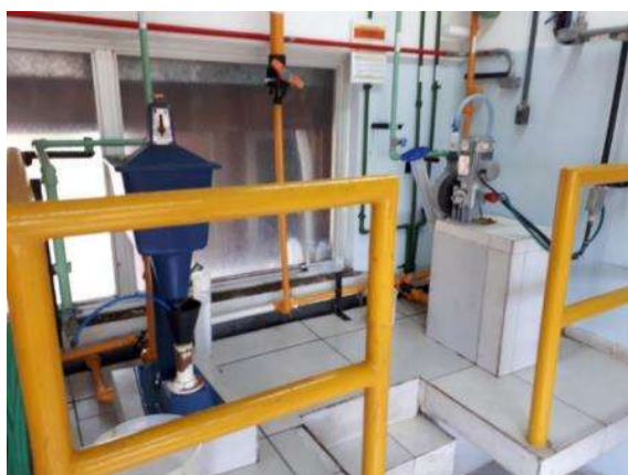
Figura 9 - A direita, dosador de nível constante de solução de sulfato de alumínio, a esquerda, equipamento de dosagem de reserva
