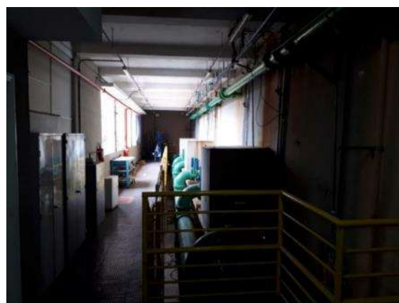
Figura 8 - Galeria do barrilete dos filtros e caixas de controle de nível
