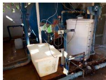
Figura 19 - Vista do filtro horizontal sob pressão e, em primeiro plano, sistemas de armazenamento e dosagem de hipoclorito de sódio e ácido fluossilícico (ETA III)
