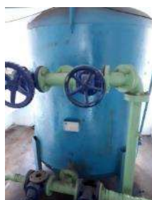
Figura 15 - Vista do filtro rápido sobre pressão (ETA I)
