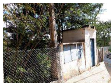
Figura 16 - Vista geral do nicho de abrigo do painel de energização e acionamento das motobombas da captação da ETA
